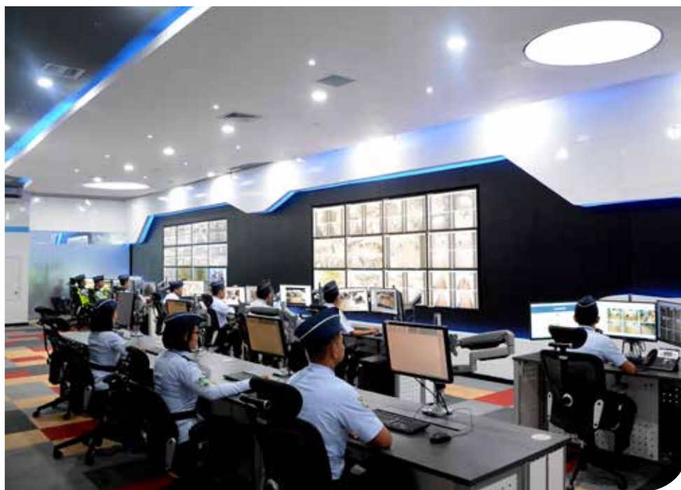
| Airport Operation Control Center (AOCC), pemanfaatan teknologi untuk meningkatkan efektivitas dan efisiensi operasional bandara.
