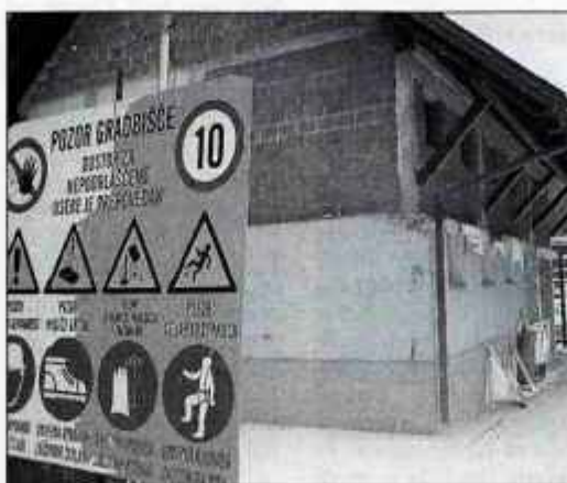
Gradbeni inšpektor je ustavil obnovitvena dela v Jasni.
