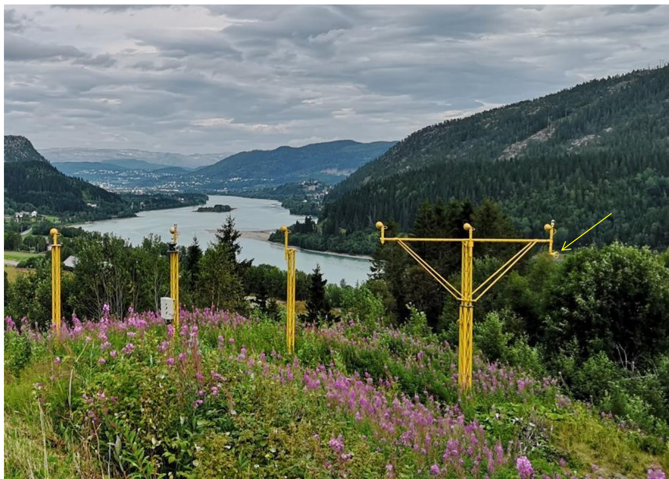
Lyskontrolllys på Mosjøen lufthavn, Kjærstad
