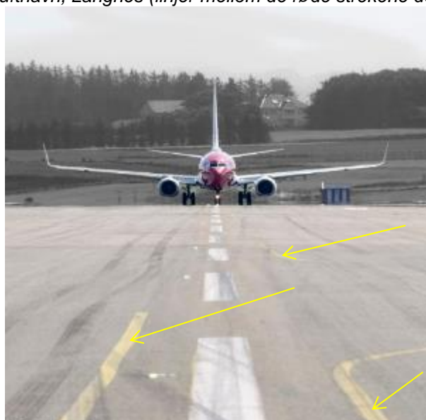
Eksempel på exit guidance line på Stavanger lufthavn, Sola
