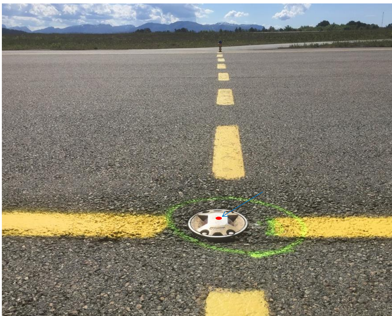
Mellomliggende venteposisjonslys på Florø lufthamn
