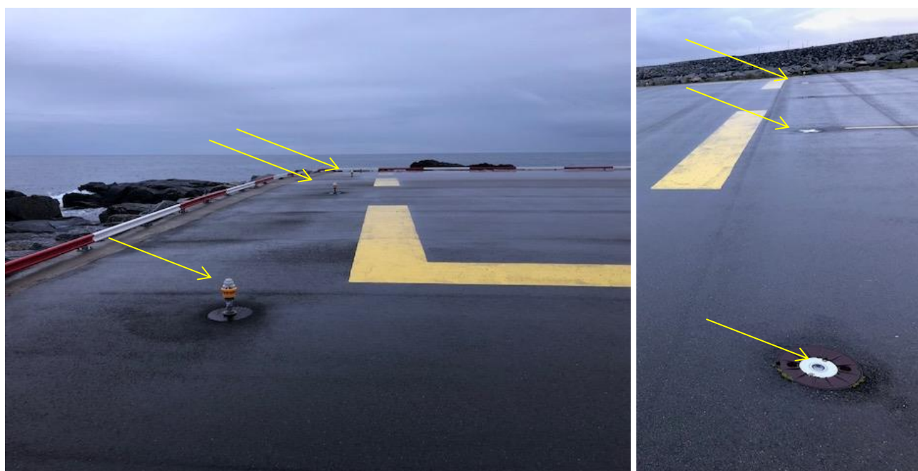
FATO kantlys på Værøy helikopterhavn (t.v. opphøyd, t.h. nedfelt)
