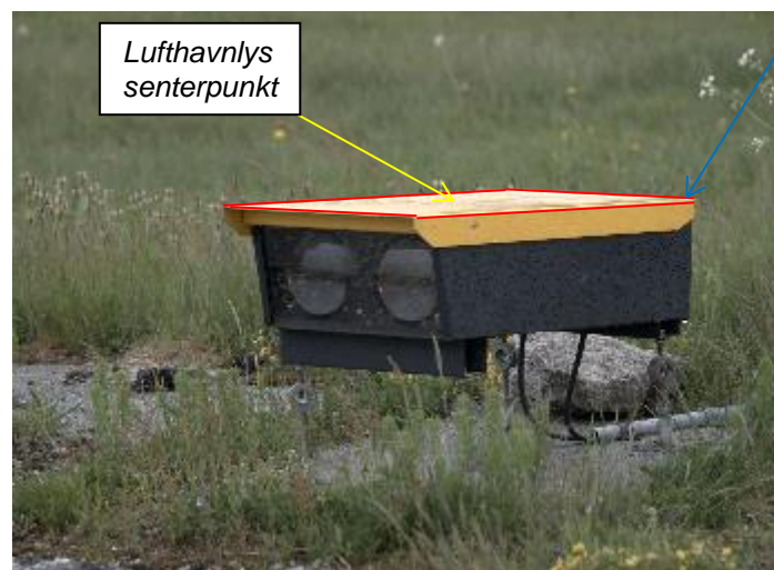
PAPI Visuelt glidebaneanlegg på Stavanger lufthavn, Sola
