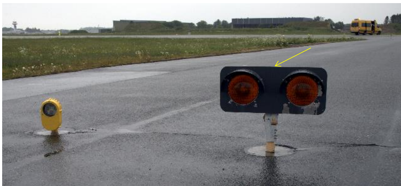
Rullebanevarsellys på Stavanger lufthavn, Sola
