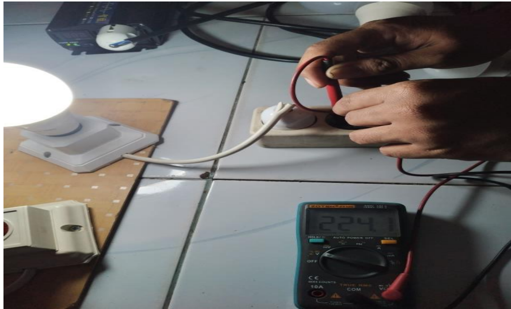
Gambar 4. 17 Pengukuran Tegangan AC pada Output Inverter Sumber : penulis, 2022
