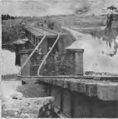
Wirkung des indischen Erdbebens vom 12. Juni 1897 auf die Manshai-Brücke der Kooch-Bihar-Staatsbahn. Nach einer Photographie.
