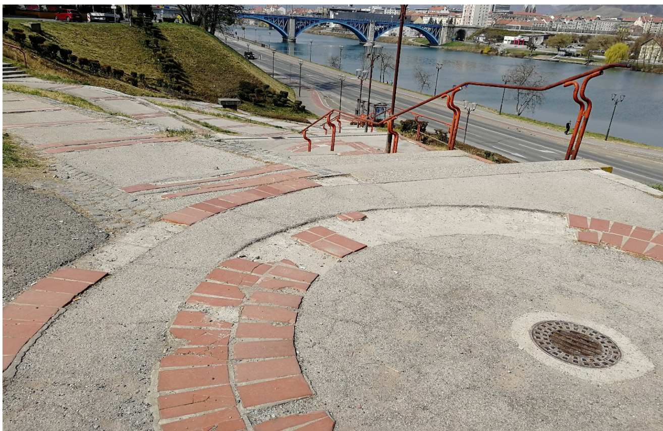
Slika 3: Poškodovana pešpot v soseski Greenwich v Mariboru
