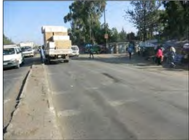
流動わだち掘れ
