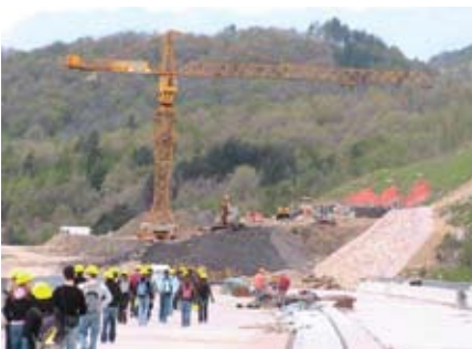
Pogled na izkop treh vodnjakov za izboljšanje varnostnih razmer pri izkopu globokega vkopa med P284 in P294 na odseku HC Razdrto – Vipava (geotehnične del projektiranja je bil izveden na Inštitutu za geotekniko UM FG).
