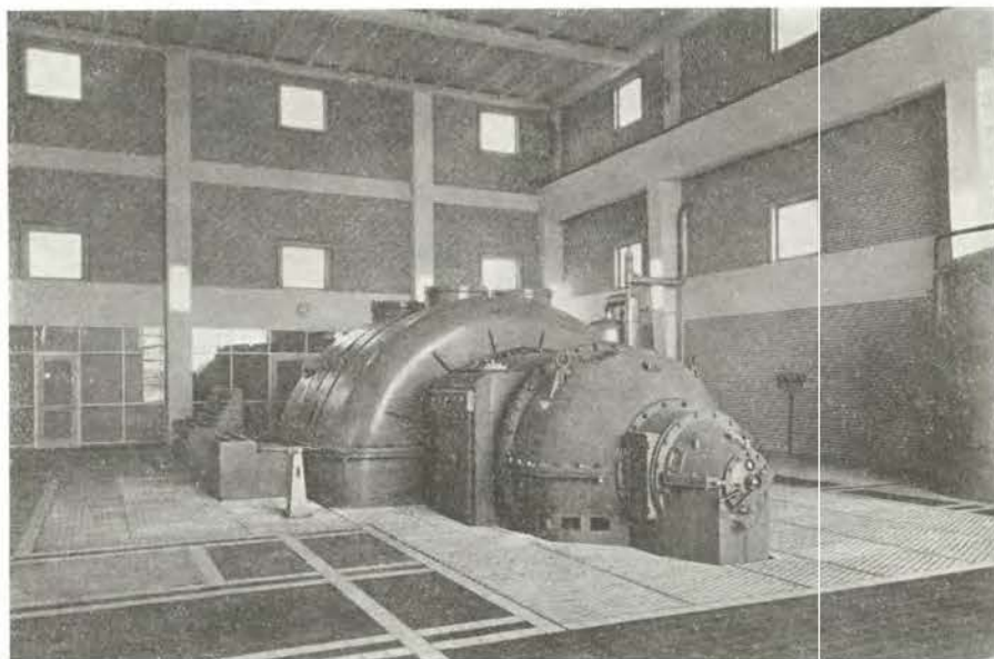
En interiör från kraftverket i Pargas: 27 MW turbogeneratoren.
