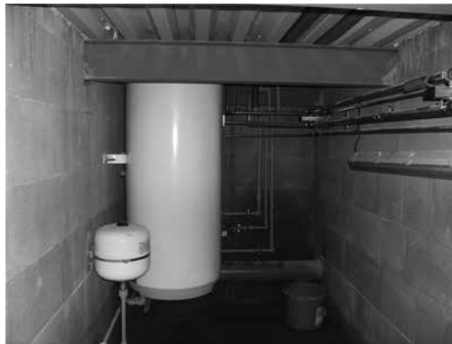
Obr. 13 Průběh realizace – zásobník teplé vody s výměníkem (foto: M. Nedvěd)
