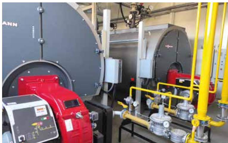
FOT. 4 Kotły gazowe
