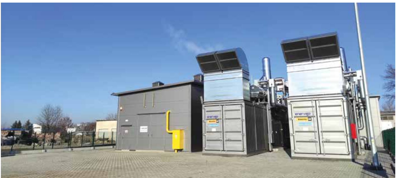
FOT. 6 Budynek kotłów gazowych oraz układ kogeneracyjny
