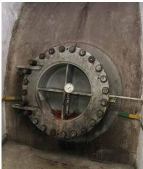
WŁAZ do turbiny używany w czasie przeglądu
