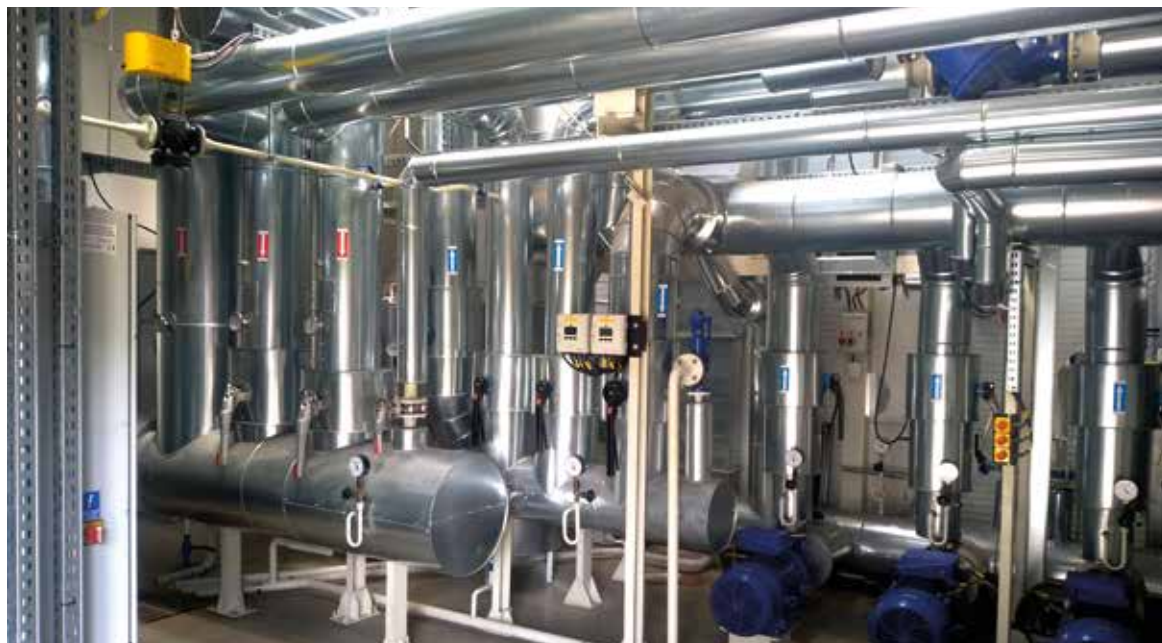
FOT. 2 Układ pompowni WDM
