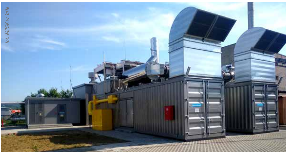
FOT. 1 Układ wysokosprawnej kogeneracji
