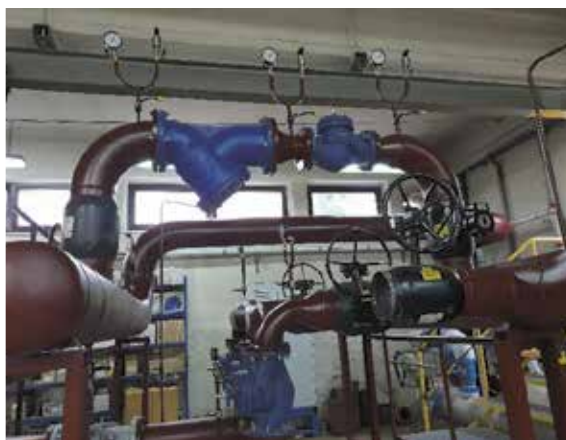
FOT. 3 Układ turbin TRC (źródło: MPEC Kraków)
