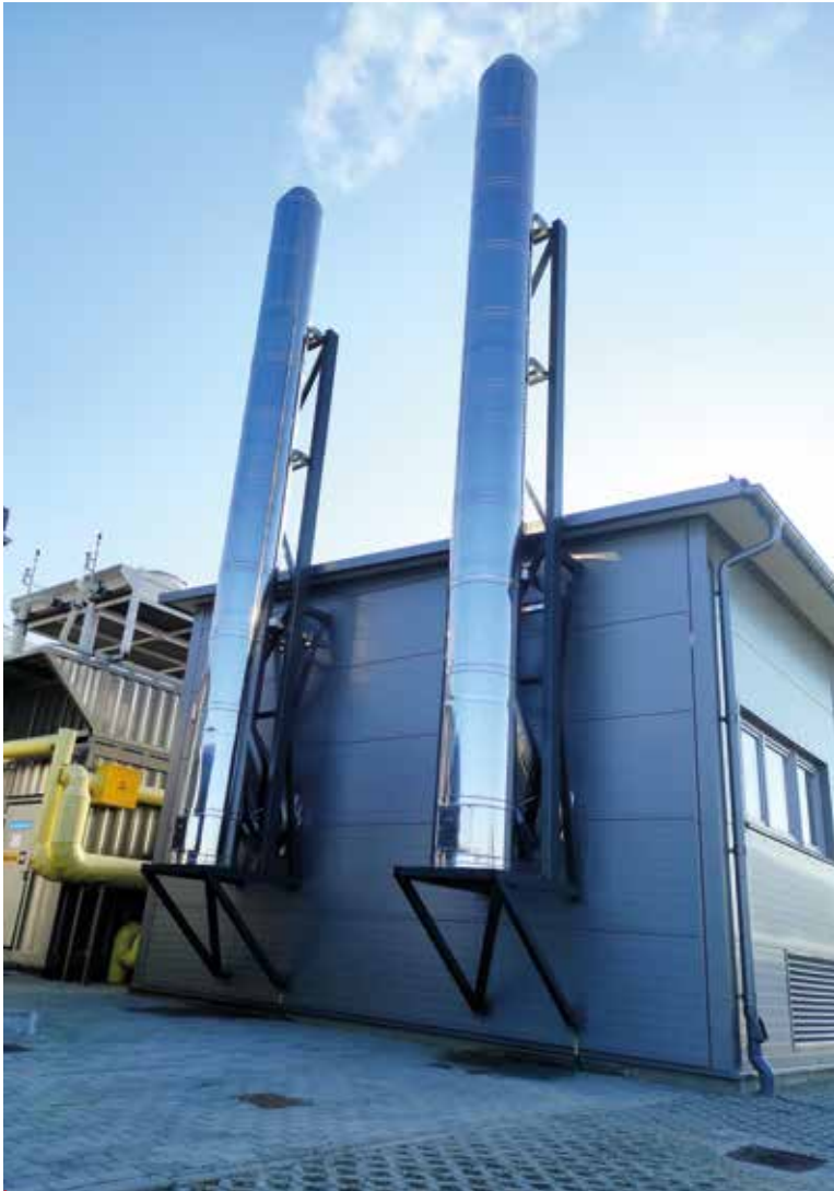
FOT. 5 Kotły gazowe
