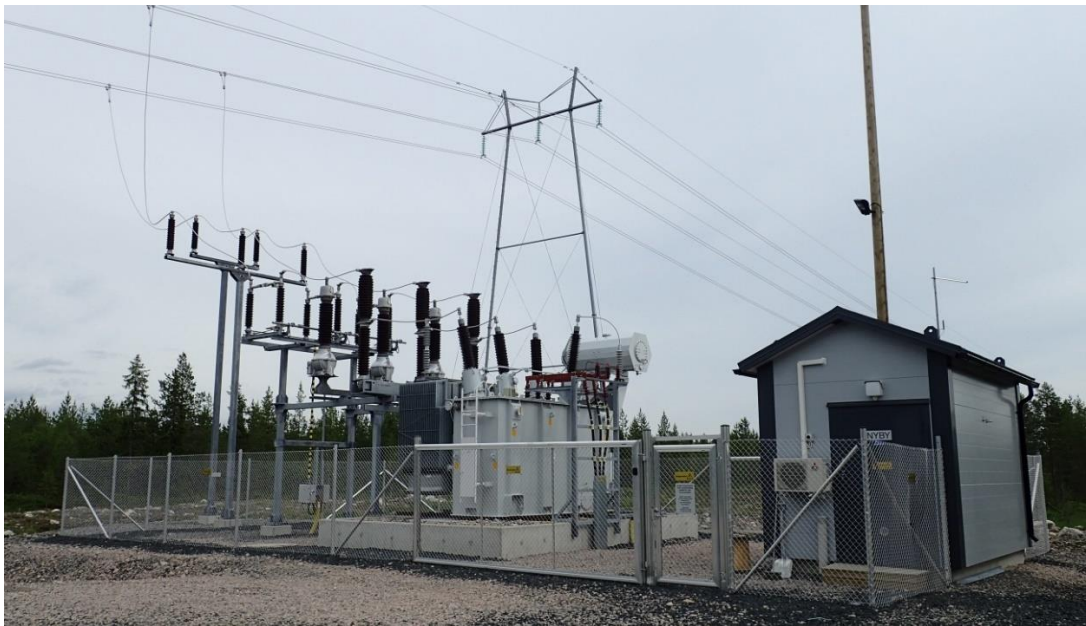
Kuva 5-8. Esimerkki tuulivoimapuiston sähköasemasta (Minna Takalo, FCG).
